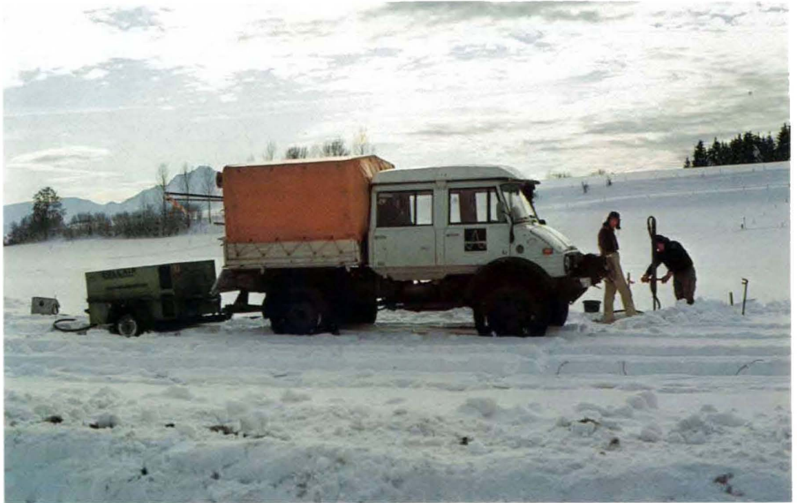
Rammhammer im Einsatz, Unimog mit Kompressor Ram hammer in action, Unimog with compressor
