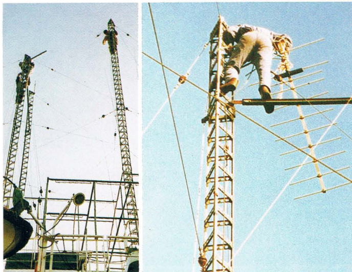
Aufrüstung der Antennen in Bergen für die Zwei-Schiff-Messung Antennae installation in Bergen for the two-ship survey
