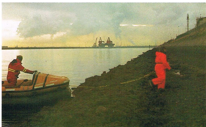
Landung an der Mole. Die Landanschlüsse werden hergestellt. A land connection being made
