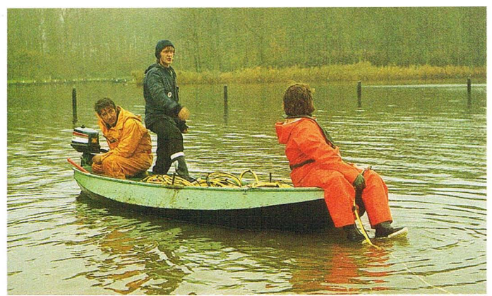
Auslegen des Grundkabels – hier eine fast idyllische Kahnpartie Laying out the bay cable – almost an idyllic rowing-boat party
