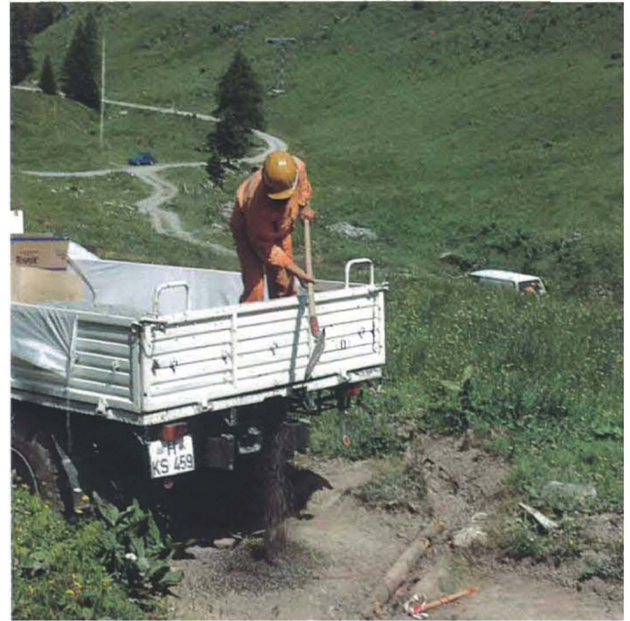
Verdämmung des Bohrloches mit feinem Kies. Die Sprengwirkung soll sich zu einem möglichst großen Anteil in seismische Energie umsetzen. Tamping of the hole with fine gravel in order to convert as much as possible of the explosive force into seismic energy.
